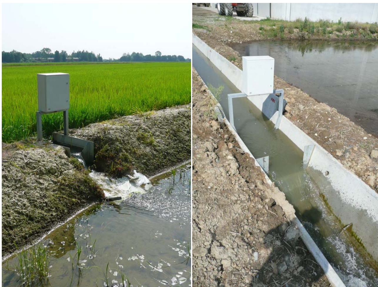
Figura 9.7: Misuratori di livello posizionati sull'argine separatore tra due risaie e in una canaletta.
