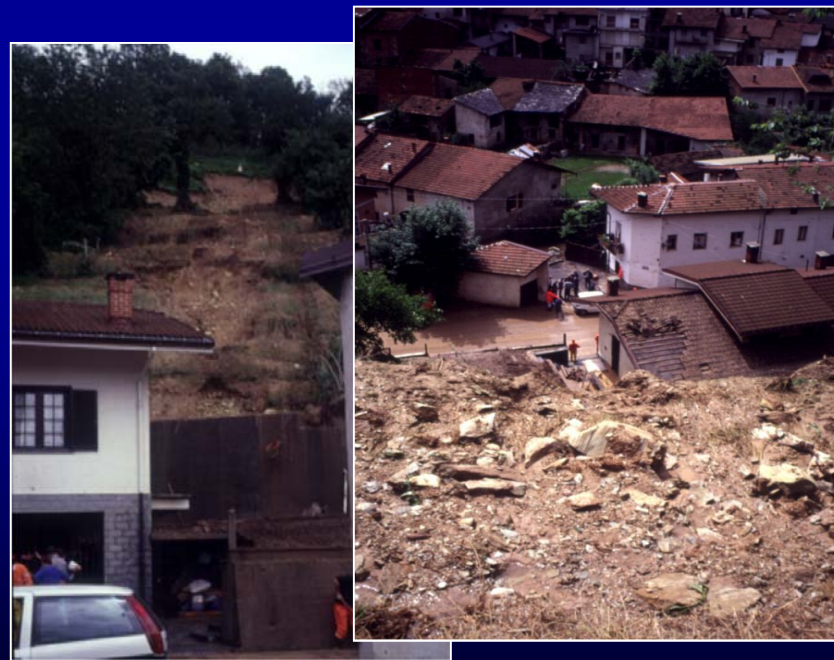
Peveragno(Cn) danni strutturali ad un edificio ( giugno 2000 )
